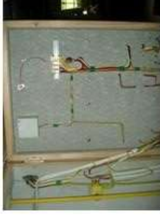
4. montierte Löschpille im Elektroschrank
